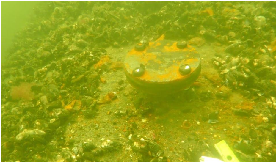
Figur 4-3. Musslor på befintlig utloppsledning. Bild från Tyréns (2022).
