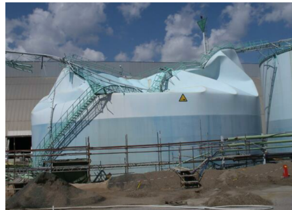
Bild 3 Kollapsad cistern i Helsingborg. Foto: Kemira kemi AB
